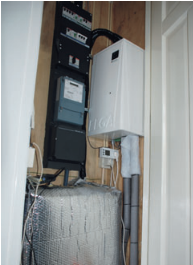
De Elga-warmtepomp werd bij de stadsverwarmingsunit in de meterkast geplaatst.
